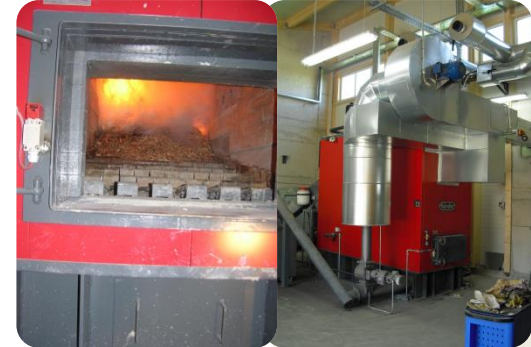
Kessel (Leistung 840 kW)
