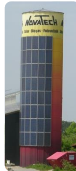
Pufferspeicher (Volumen: 150.000 l; Speicherkapazität ca. 6.000 kWh)
