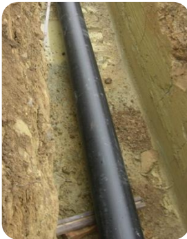
Nahwärmeleitung zur Versorgung der Wohn- und Gewerbegebiete
